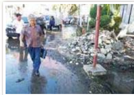
道路にまで漏水している様子
