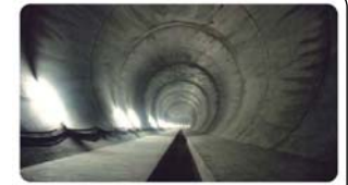
江川雨水貯留管
