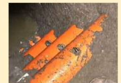
破損状況(拡大)
