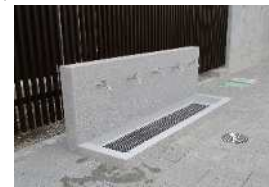
開設不要型応急給水拠点
