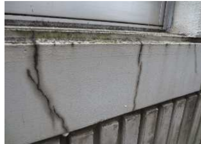
壁面のひびわれ
