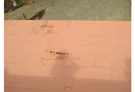
金属板屋根塗装はく離
