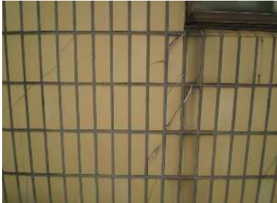
タイル面のひびわれ
