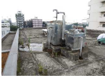
保護コンクリート劣化
