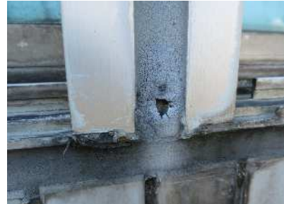
シーリング割れ
