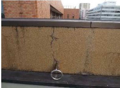
壁面のひびわれ
