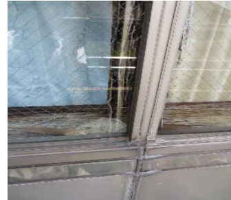
シーリングの変形
