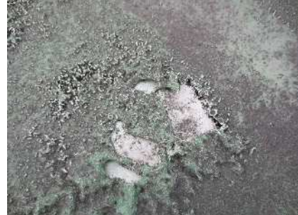
ウレタン塗膜防水破れ
