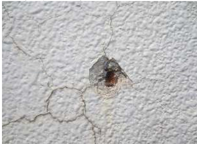
コンクリートを含むはく落(鉄筋露出)
