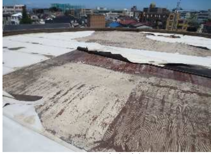
シート防水破れ
