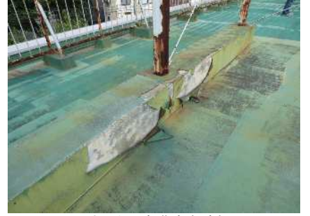
ウレタン塗膜防水破れ
