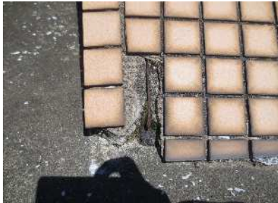
コンクリートを含むはく落(鉄筋露)
