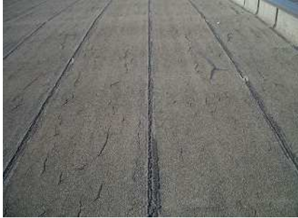
アスファルト防水劣化
