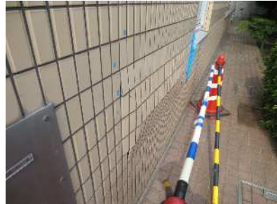
タイルの浮き
