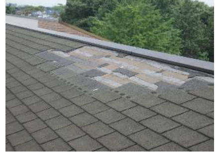
アスファルトシングル劣化
