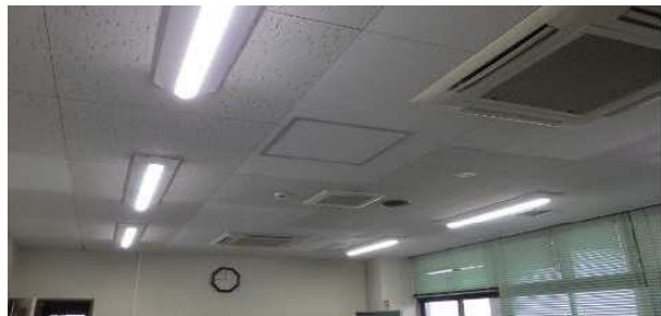
LED照明設備
