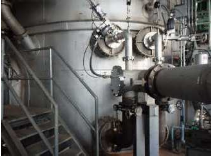
一酸化二窒素と窒素酸化物を削減する技術の試験設備
