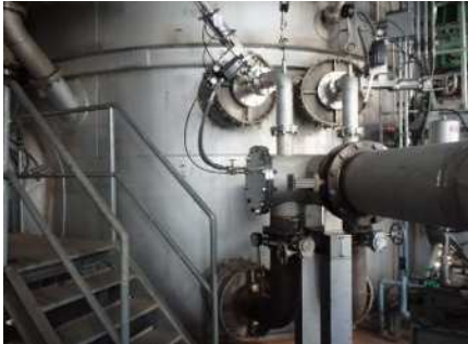
一酸化二窒素と窒素酸化物を削減する技術の試験設備
