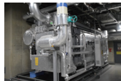
日本電気(株) 冷凍機
