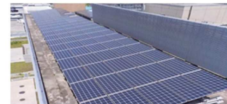
入江崎水処理センター
