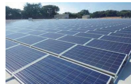
配水池上部の活用事例 (太陽光発電)
