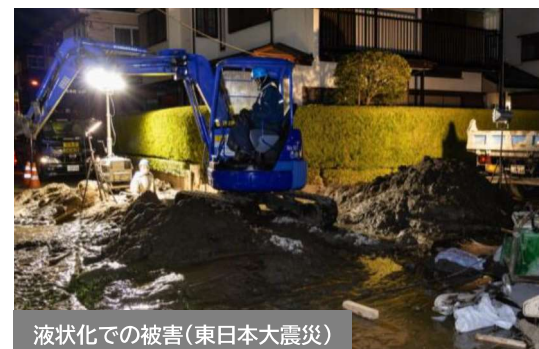
液状化での被害(東日本大震災)
