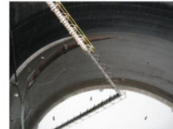
浮き屋根上に溢流→14日 浮き屋根沈没
