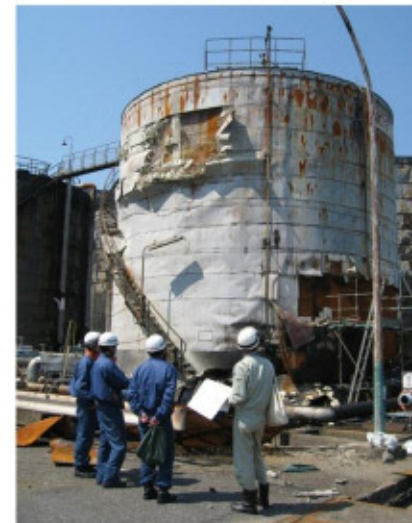
隣接区画のアスファルトタンクの側板が損傷
