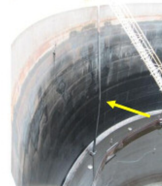
ゲージポールの変形
