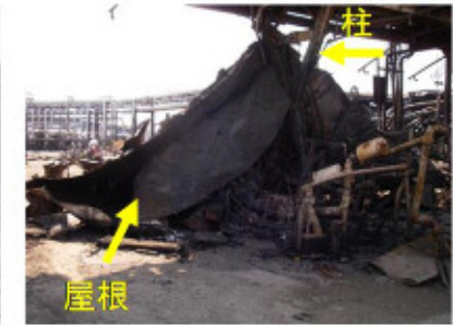
アスファルトタンクの屋根はガス出荷場 の柱に衝突して止まっていた。 移動距離は116m。
