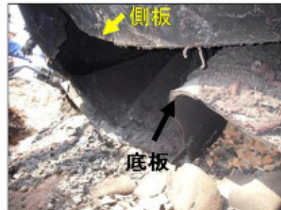
底板と側板は長さ約2.4mにわたり破断
