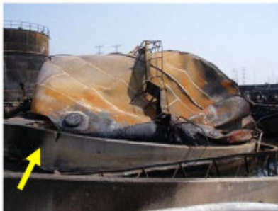
焼損したガソリンタンク 基礎のコンクリートリングが傾斜
