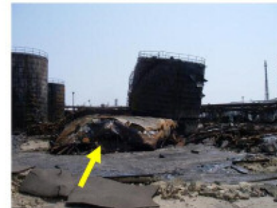
倒壊、焼損したアスファルトタンク
