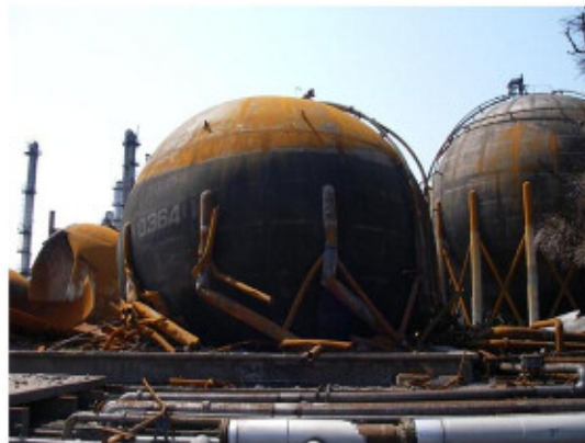
ガスタンクの支柱が座屈し配管を損傷
