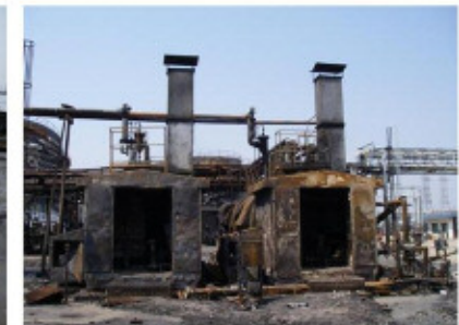
アスファルトを加温するための 油を加熱する炉も焼損している。
