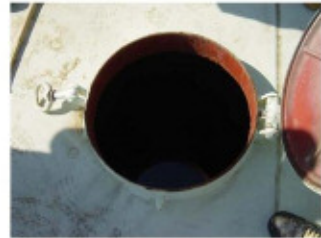
ポンツーン内への原油の滞油
