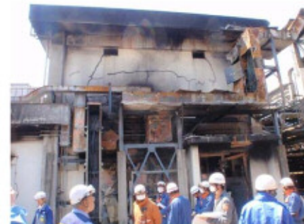
製造装置の制御室の焼損
