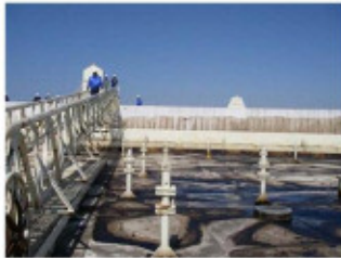
デッキ上への漏洩
