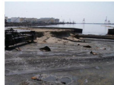
消失した護岸と近傍の地盤の 流出(アスファルトタンク近傍)
