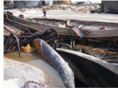
防油堤近傍は洗掘され、防油堤が 壊れている
