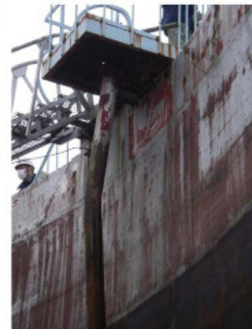
ゲージポールの変形 スロッシング波高約 1.4m
