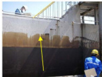
側板の油痕 スロッシング波高約 1.8m
