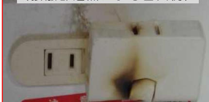
(接触部過熱による出火例)
