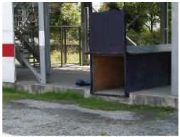
B塔 煙道出口
