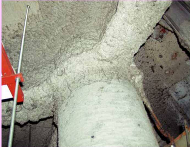
吹付けアスベスト
