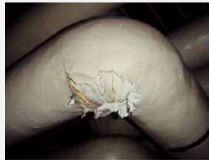
アスベスト保温材 (配管の断熱被覆)
