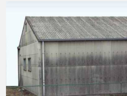
アスベスト含有スレート波板 (工場の屋根・壁)
