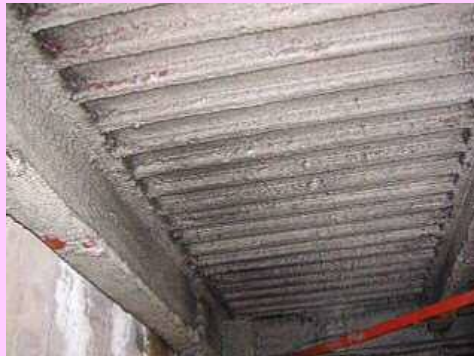
アスベスト含有吹付けロックウール (鉄骨材の耐火被覆)
