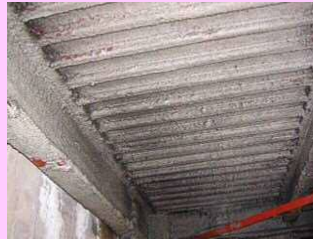
アスベスト含有吹付けロックウール
