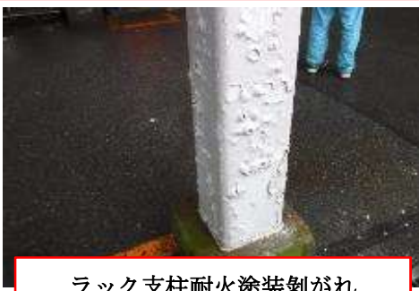
ラック支柱耐火塗装剥がれ
