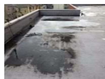
屋上防水の滞水、防水層膨れ
