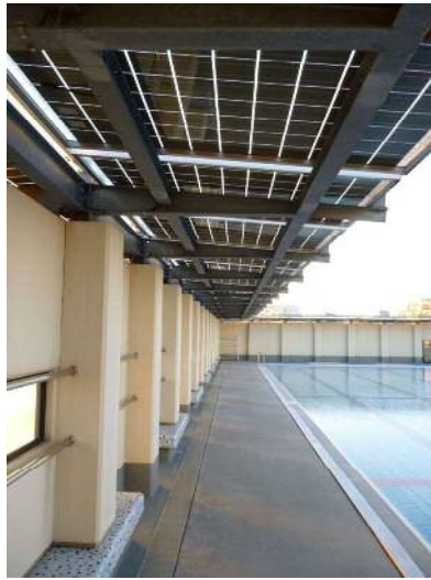
プールサイドの日除けに設置された 太陽光発電パネル
