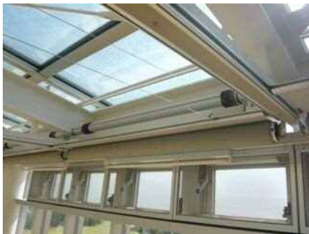
図 3-4 自然換気窓 (杉並区立天沼小学校)
