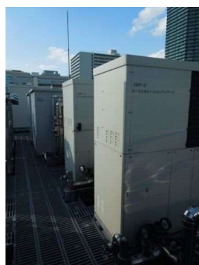
屋上のクーシェネ機器
