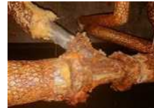
老朽化した配管
