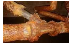
老朽化した配管
