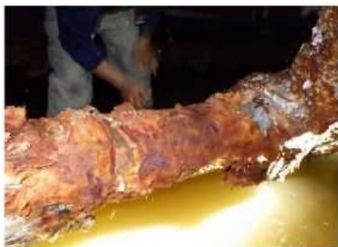
トイレ排水管の腐食の状況
