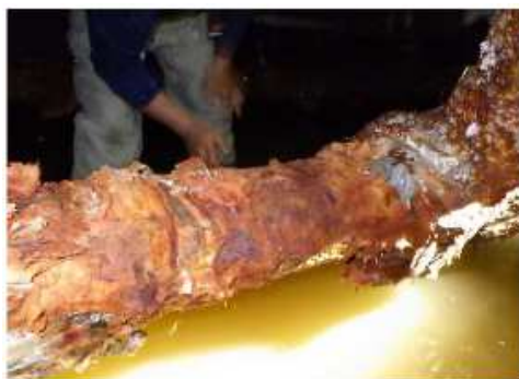
トイレ排水管の腐食の状況
