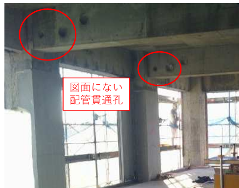
①-2 図面がない開口
