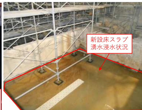
③大ホール新設床スラブに湧水
