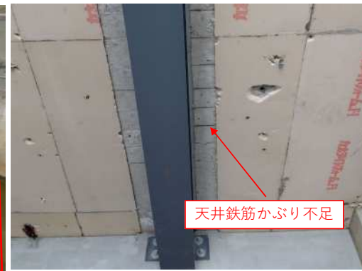
④5階天井スラブ下かぶり不足
