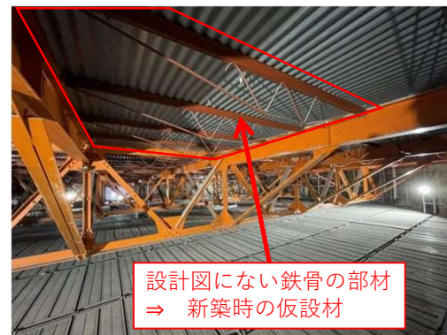
【②－3：大ホール屋根鉄骨梁の違い】
