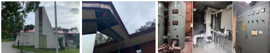
躯体の劣化が著しい エネルギー棟 渡り廊下軒裏の破損 ボイラー 消火設備 受変電設備 (耐用年数を超えた設備)
