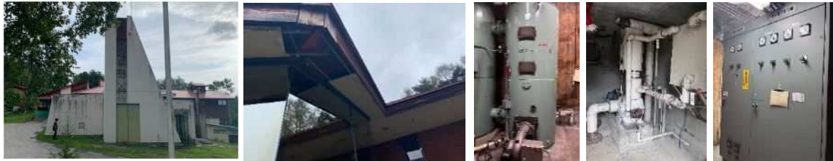
躯体の劣化が著しいエネルギー棟
