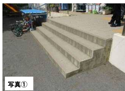
階段に手すりが設置されていない
