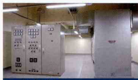
B1 自家発電機室
