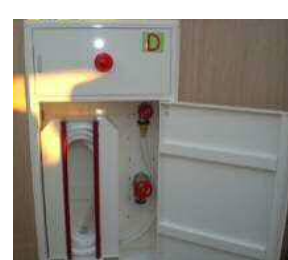
新規格の消火栓
