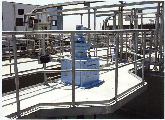
生物処理沈殿掻き機
