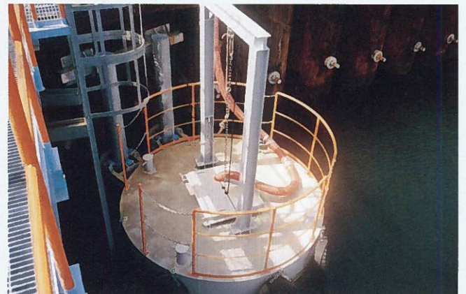
原水揚水ポンプステージ
