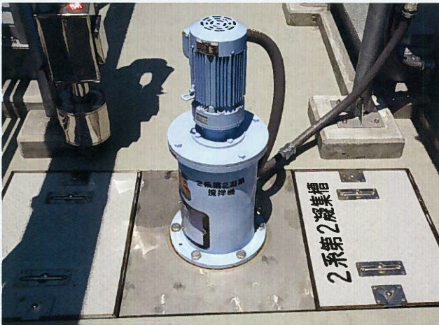
第2凝集攪拌機
