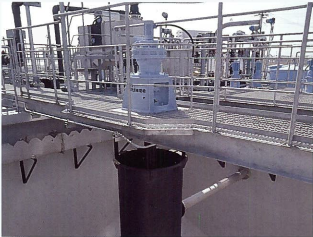
第1凝集沈殿汚泥掻き機
