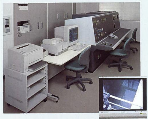
第2凝集沈殿槽監視モニター
