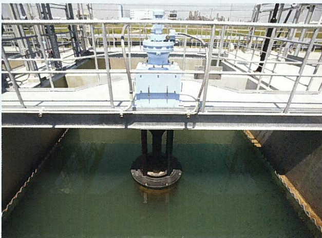
第2凝集沈殿汚泥掻寄機
