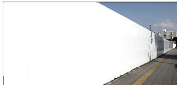
仮囲いの設置による遮音対策の例
