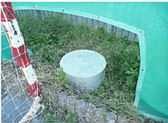
② スプリンクラー設置状況
