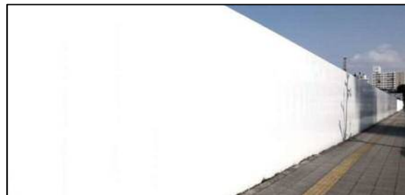
仮囲いの設置による遮音対策の例
