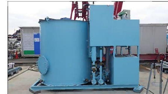
濁水処理設備
