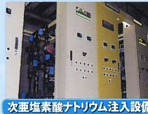
次亜塩素酸ナトリウム注入設備
