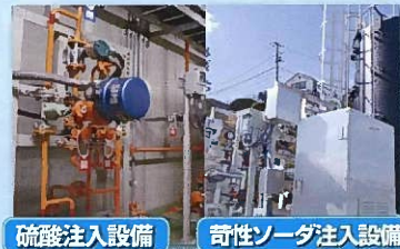
硫酸注入設備
