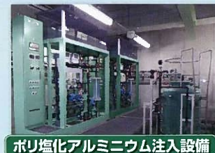
ポリ塩化アルミニウム注入設備
