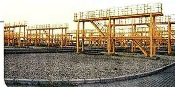
リーファー電源 Power points for a refrigerated container
