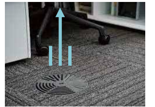
床吹き出し口の一例
