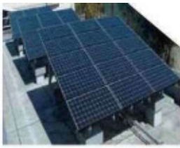
太陽光パネル
