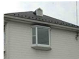
写真6: 石綿含有成形板(窯業系サイディング外壁)
