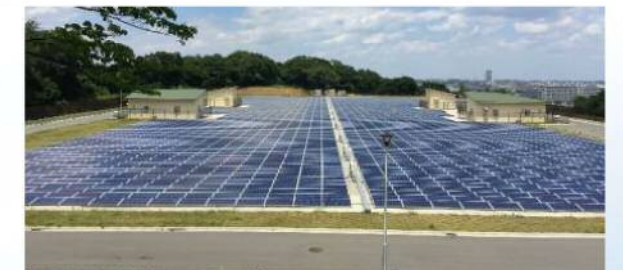
生田配水池に設置した太陽光発電設備
