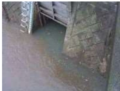
雨天時に放流される未処理下水
