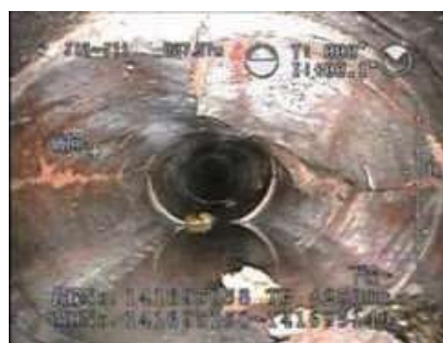
下水管きよの劣化状況
