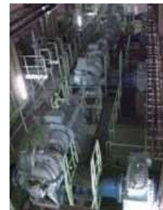
高効率な工水2号送水ポンプ
