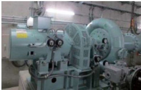
平間発電所小水力発電設備
