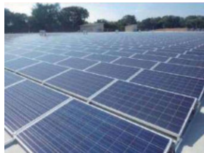
生田配水池太陽光発電設備
