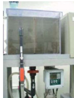
水質計器による常時監視
