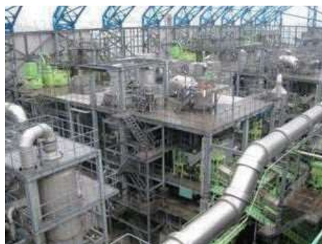
入江崎総合スラッジセンター 汚泥焼却施設
