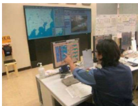
中央監視制御装置による施設の運転
