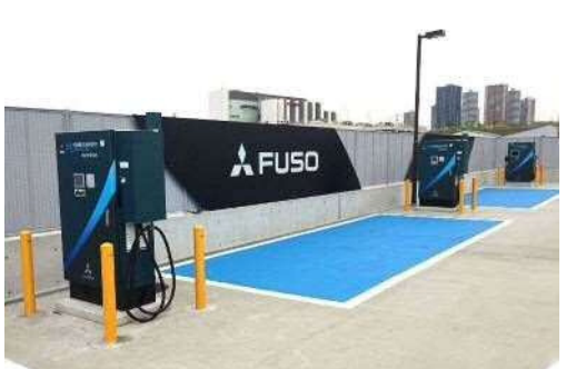
電気トラック用急速充電設備※3 (三菱ふそうトラック・バス(株)川崎工場内)
