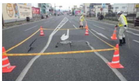
■ 平成28年4月熊本地震被害の状況
