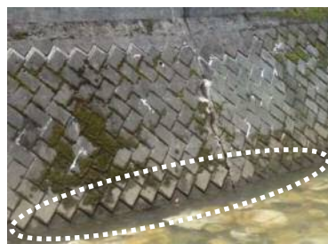
護岸の変状(ブロック隙間の拡大)
