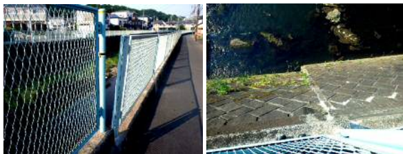
変状による護岸施設の見直し
