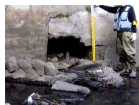
護岸背面部の空洞
